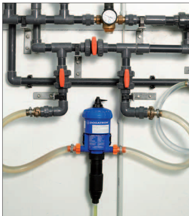
Водопровод с медикатором
